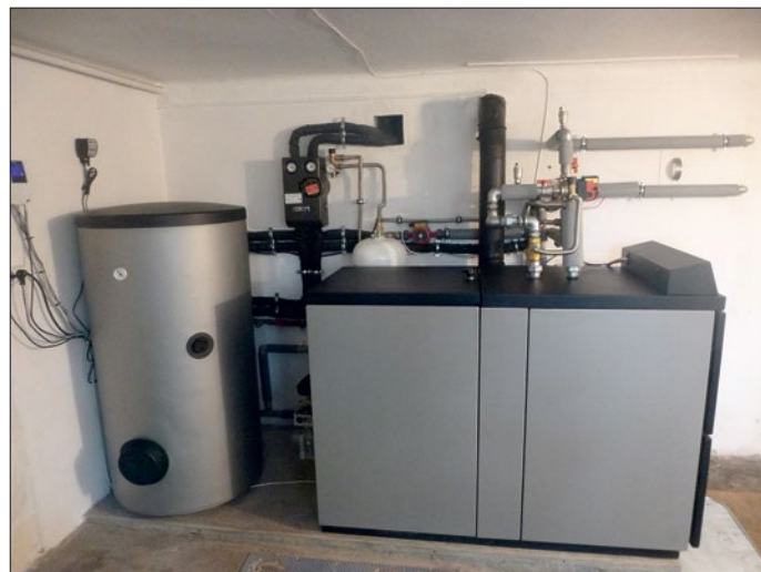
Zmodyfikowana kotłownia na biomase (32 sztuki)
